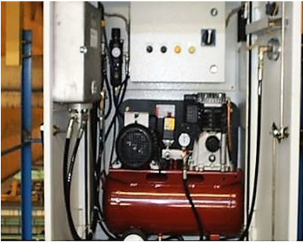
Kompressor mit Steuerung
