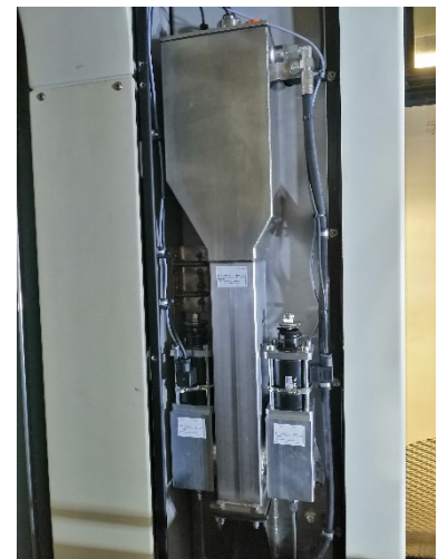
Tank und Pumpen
