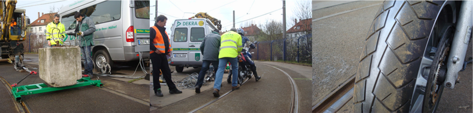
Mesures du coefficient de friction. Passage en charge sur le segment de courbe traité préalablement. Pneu traité directement.
